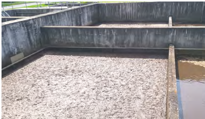
Voda přitékající na ČOV kanalizací - denně cca 550 m 3
